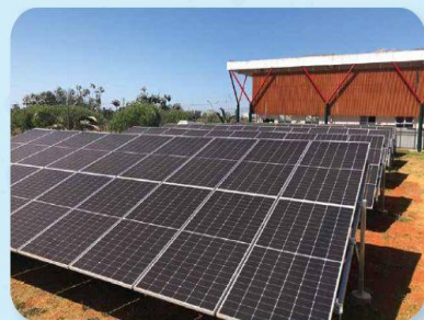
USINAS FOTOVOLTAICAS ETAPA II NOS DEZ CAMPI (Samambaia)
